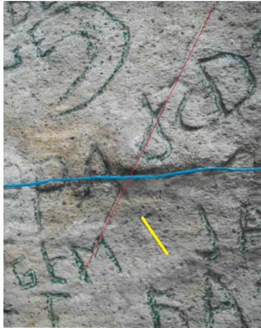
Détail de la photo page 58 – La fissure dans son ensemble
