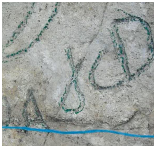
Détail de la fissure en page 54 du dossier
